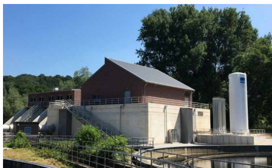
Ozonstufe auf der Kläranlage Aachen-Soers, Wasserverband Eifel-Rur (Foto: Wasserverband Eifel-Rur)
